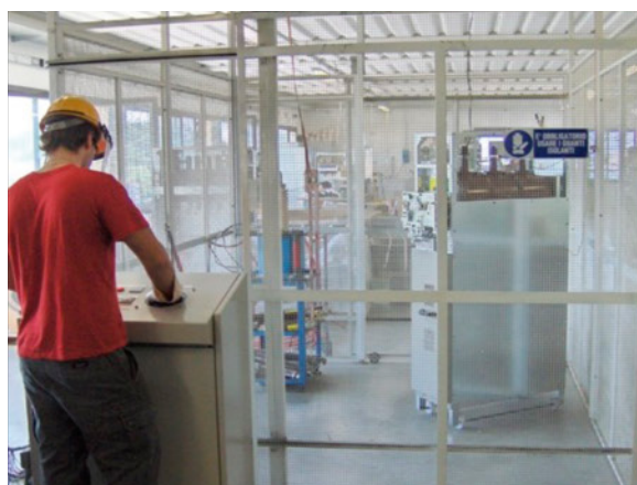
Control de rigidez dieléctrica.
